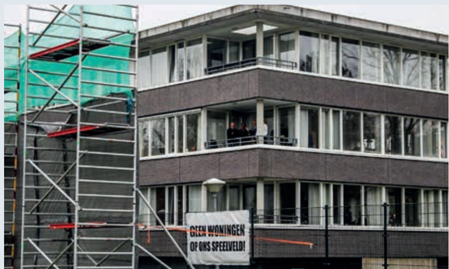
Bezoek van burgemeester Lenferink en wethouder Damen bij bewoners aan de Burggravenlaan. De steiger geeft de plaatsing van de woonunits aan.
