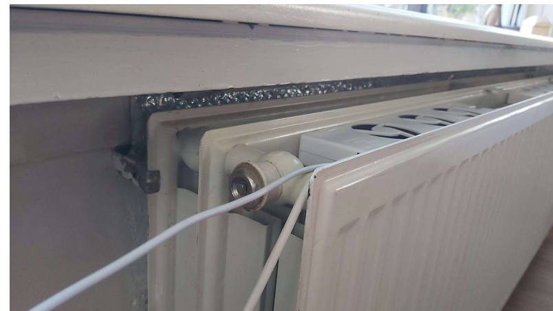
Radiatorfolie en radiator-ventilatoren (hier aan bovenkant; beter aan onderkant)
