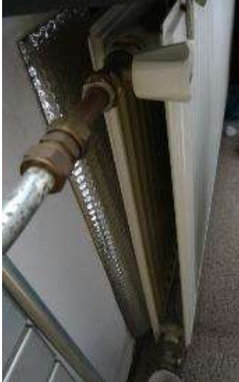
Radiator met radiatorfolie
